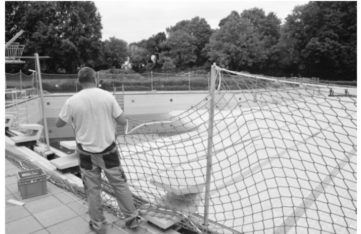
Für die Sanierungsarbeiten werden die Becken mit Netzen abgesichert. Foto: Stadt Kehl
